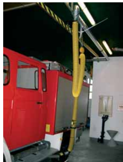
Neue Absauganlage in Eudenbach
